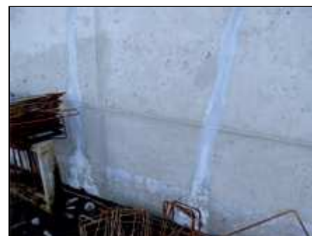
Marca de cristales después de 4 días, sin fugas de agua
