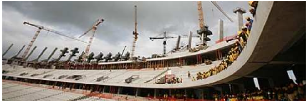
Estadio de la Copa del Mundo de 2010, Ciudad del Cabo, Sudáfrica, impermeabilizado con Penetron Admix
